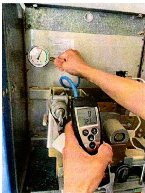
CELDA DE PROTECCION (TRAFO 1)
