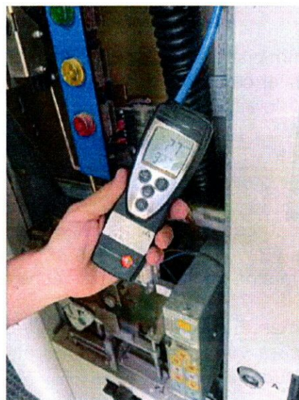
CELDA INTERRUPTOR AUTOMATICO
