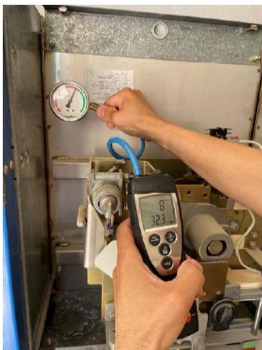
CELDA DE PROTECCION (TRAFO 1)
