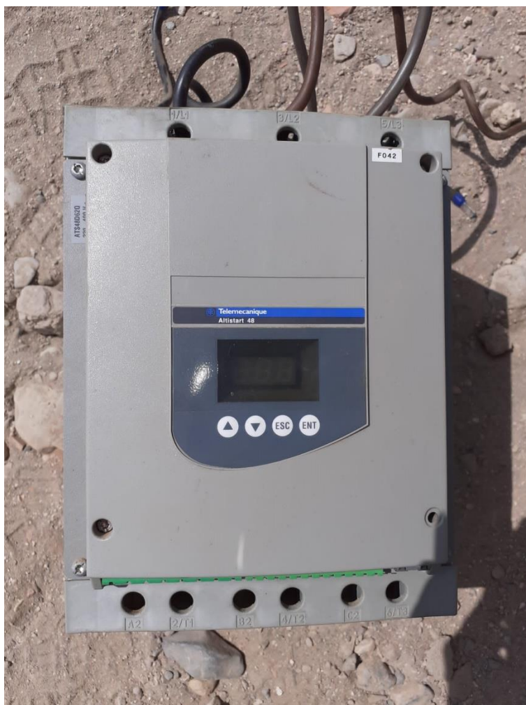
Arrancador estático de la bomba A de la EBAR Balanegra averiado
