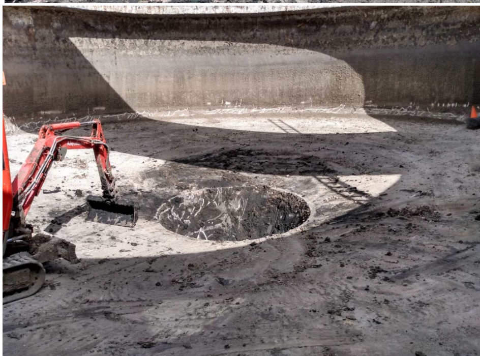
Estado de depósito durante actuación y final tras limpieza.
