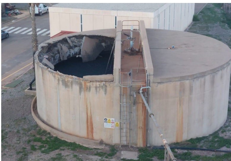
Derrumbamiento cubierta dep. tampón.
