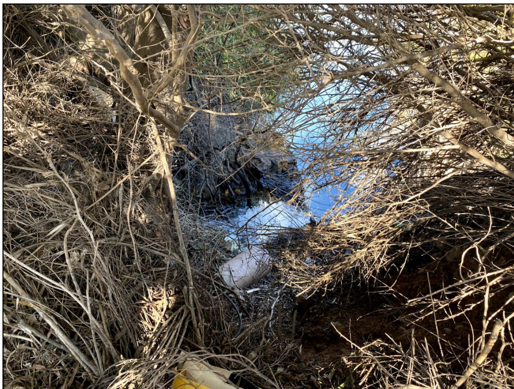
Fotografía 2.- Detalle de la tubería de vertido de las aguas depuradas.
