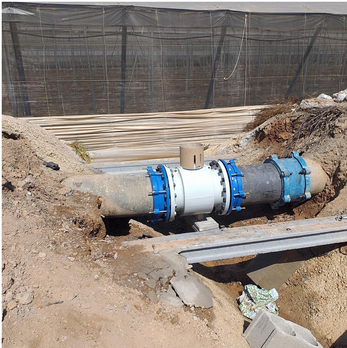
Fotografía de caudalímetro de contabilización de agua de salida de emisario submarino conectado a telecontrol
