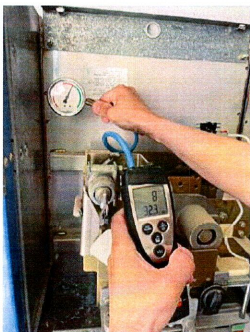
CELDA DE PROTECCION (TRAFO 1)
