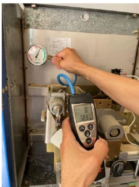
CELDA DE PROTECCION (TRAFO 1)
