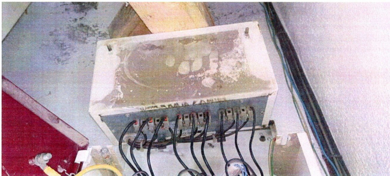
Fotografía de la estación de condensadores de la EDAR Dalías averiada
