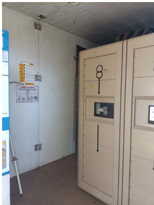
Fotografía 4: Imagen del CT.
