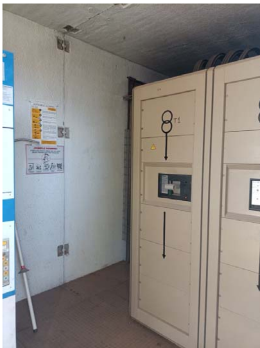
Fotografía 4: Imagen del CT.
