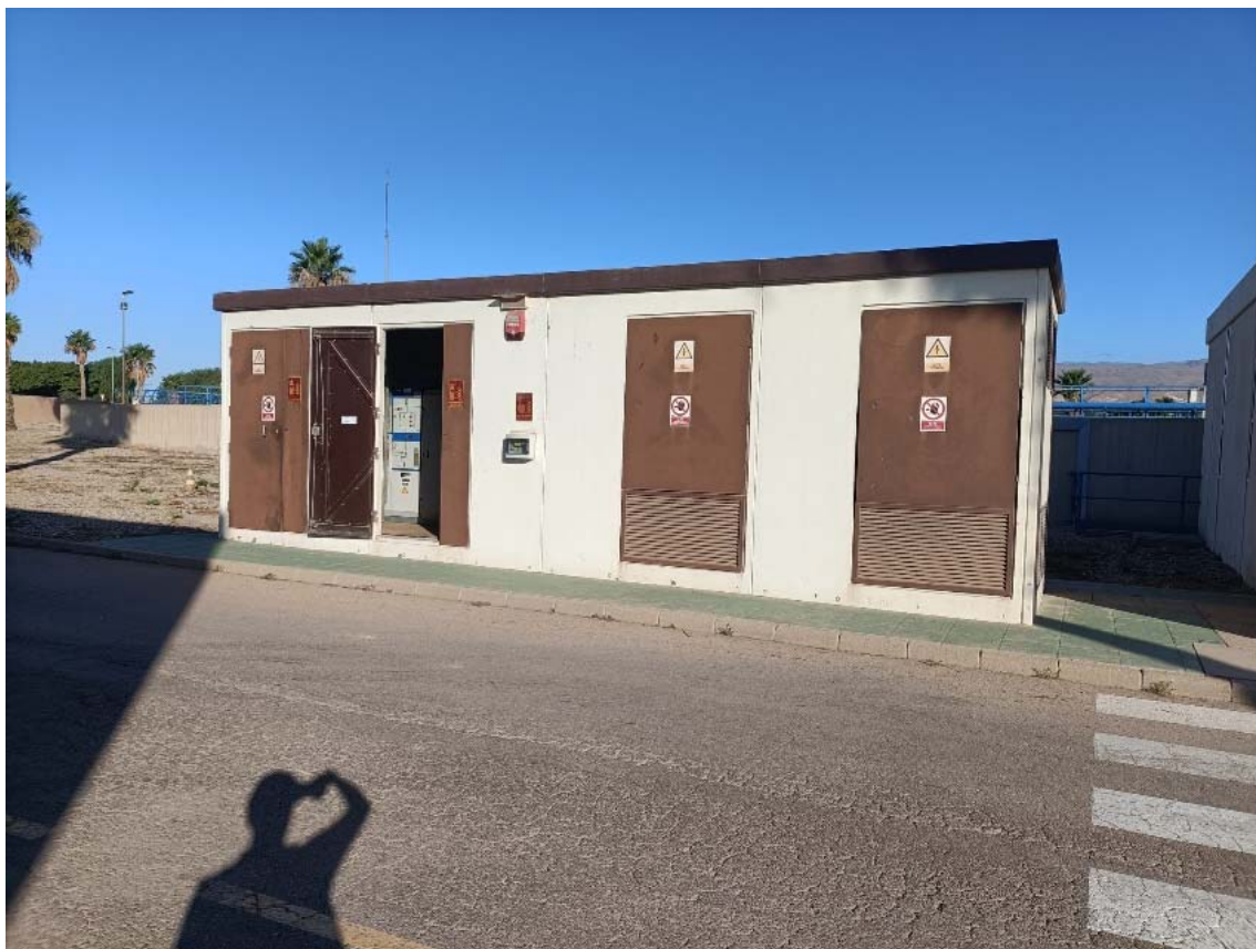
Fotografía 3: Imagen del CT.
