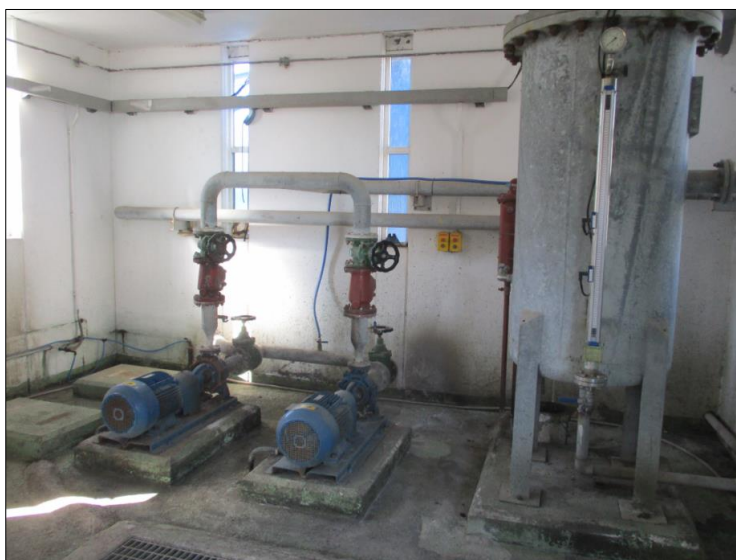
Fotografía 3.- Vista bombas horizontales y calderín de presurización.
