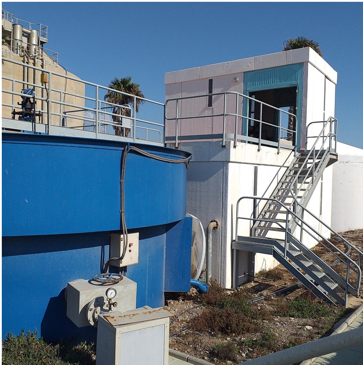
Fotografía del espesador por flotación (en azul) y el edificio de presurización a su lado
