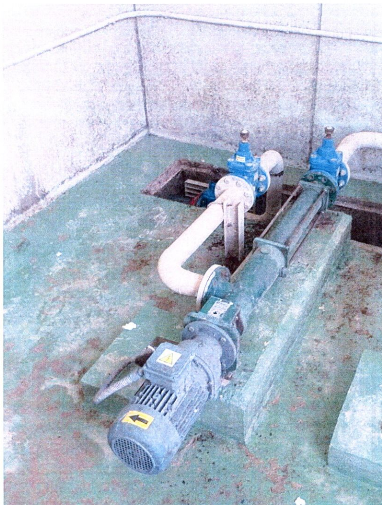
Bomba de fangos digeridos a espesador por gravedad de la EDAR Balerna
