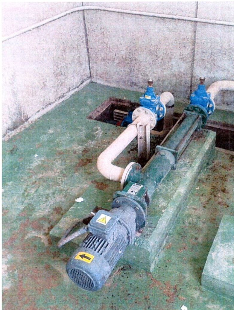
Bomba de fangos digeridos a espesador por gravedad de la EDAR Balerma
