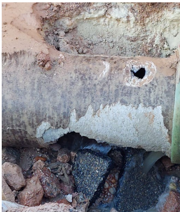
Imagen 4. Rotura causante de la avería en la canalización de impulsión.
