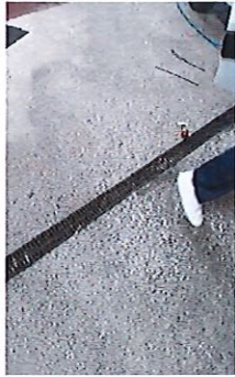
REJILLAS EN EL SUELO
