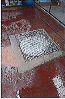
SEPARADOR DE HIDROCARBUROS
