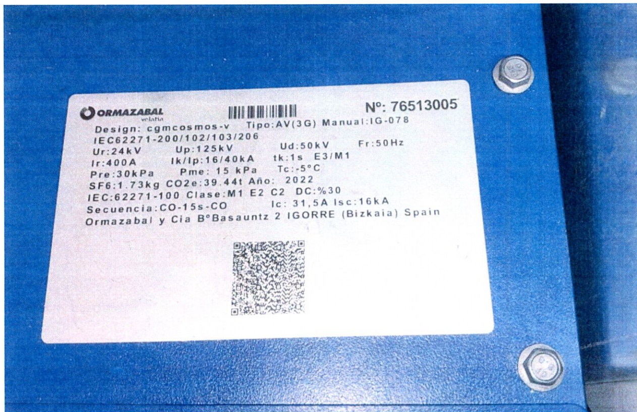
Placa de características de la última cabina instalada
