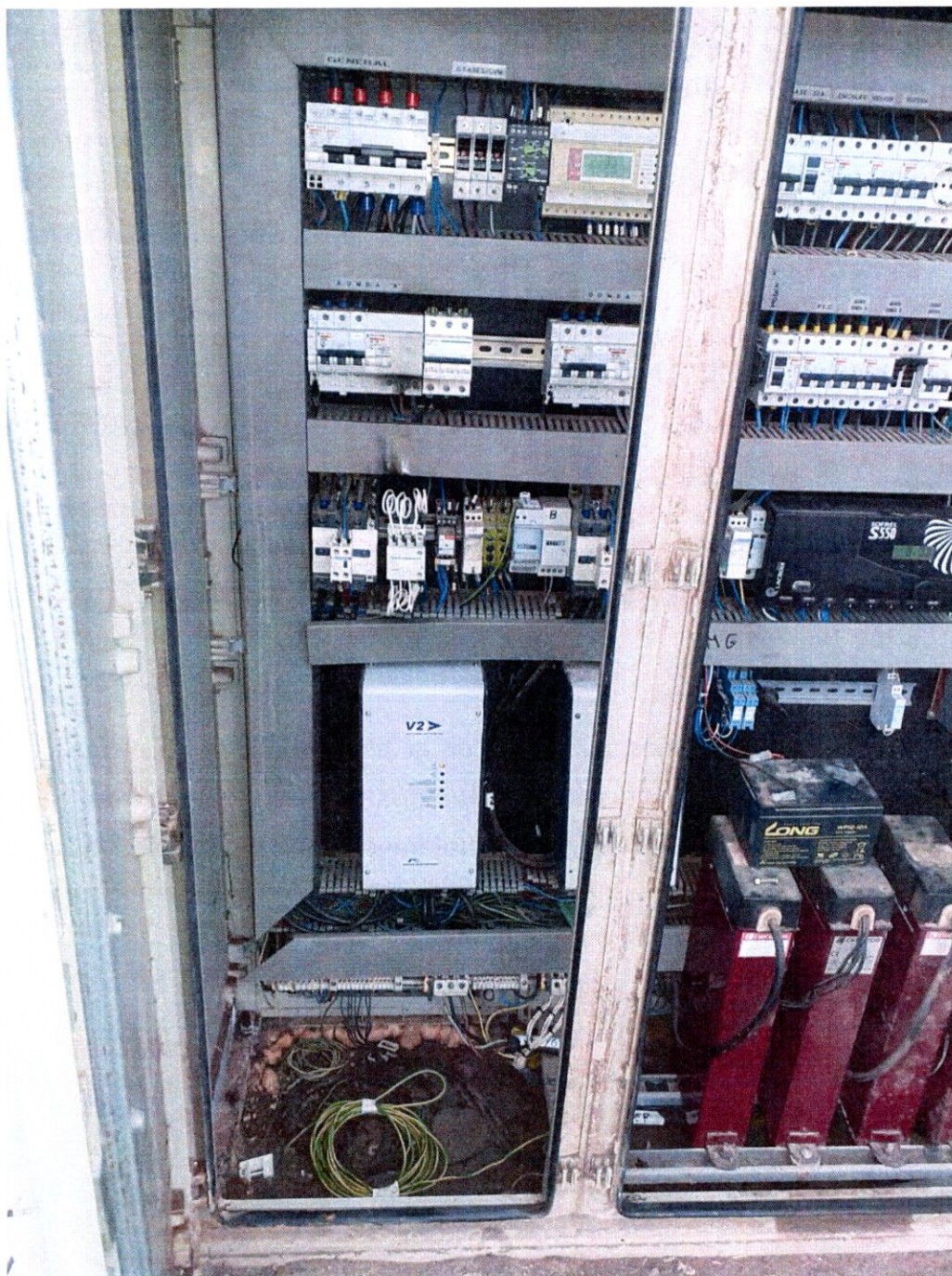
Fotografía arrancador estático instalado y en funcionamiento
