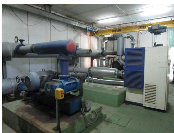
Vista de equipos soplantes P3 y P4.
