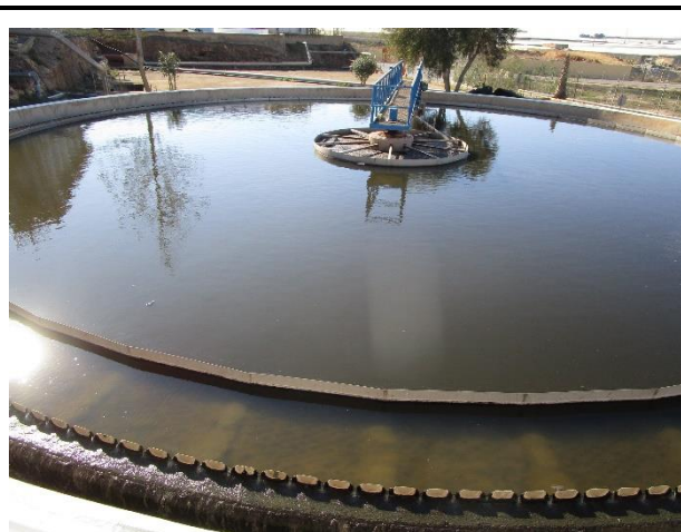
Vista del clarificador "A", donde se puede apreciar parte de la corona circular donde se alojan las lamelas.
