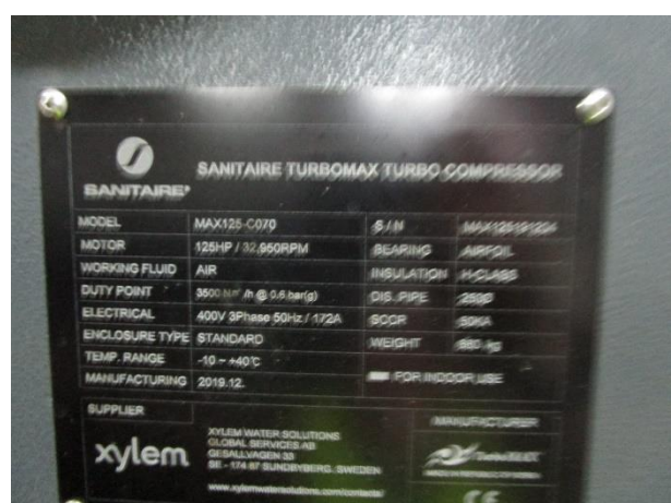
Placa del turbocompresor (P1)
