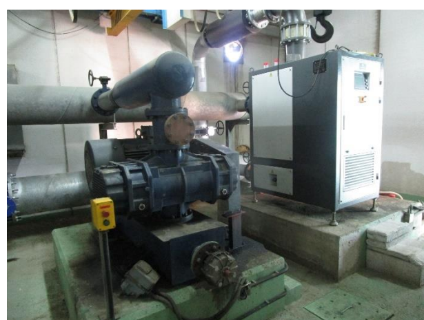
Vista de equipos soplantes P1 y P2.
