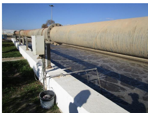
Colector de aire y armario que alberga el controlador de la sonda de OD ubicada en RB "A".
