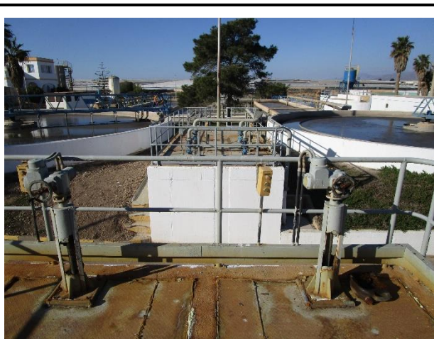
Vista parcial de los decantadores primarios.
