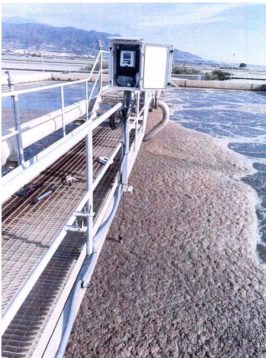
Fotografía de controlador de ambas sondas de medición de oxígeno, instalado en reactor biológico A, junto con la sonda instalada para medición en el mismo
