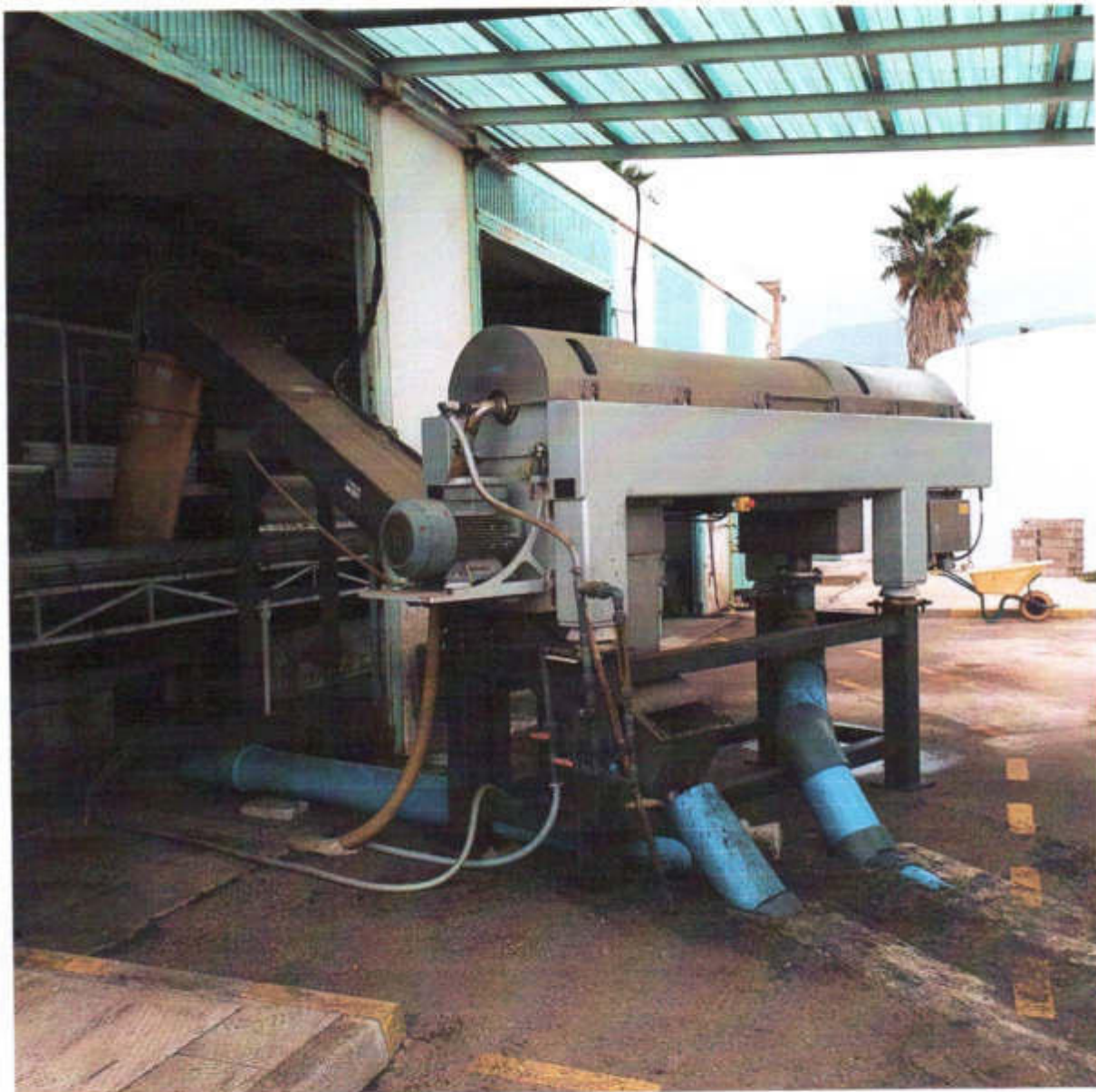
Centrífuga instalada por Depuración Poniente Almeriense U.T.E. en 2019
