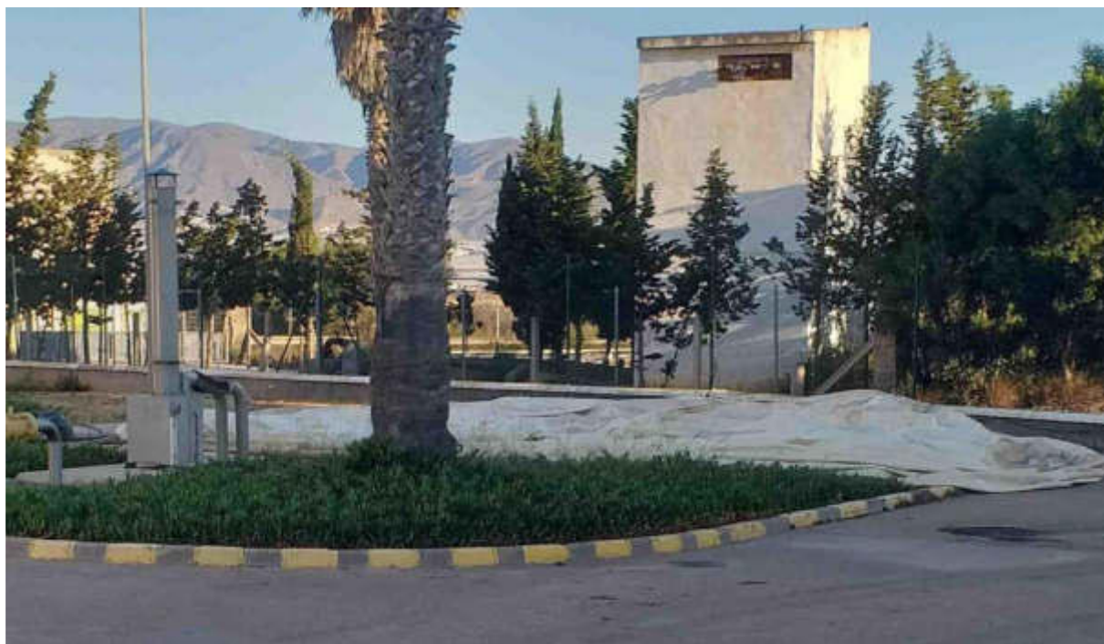
Estado del depósito de acumulación de gas actual, inoperativo por falta producto
