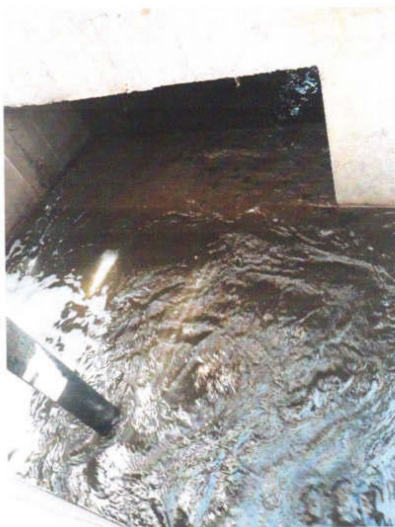
Arqueta de salida colmatada y retorno del agua que no puede salir hacia el depósito de agua previa al tratamiento terciario
