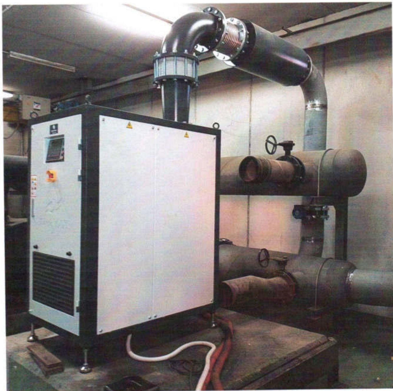
Soplante de levitación por aire instalada en 2020
