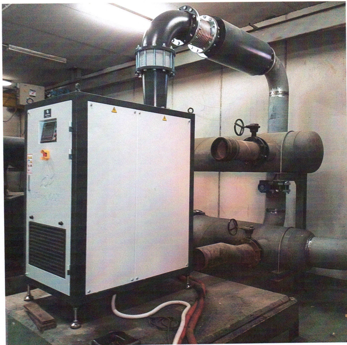
Soplante de levitación por aire instalada en 2020
