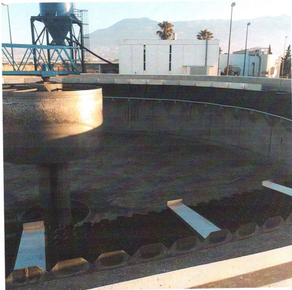
Decantador secundario B con lameias en su perímetro
