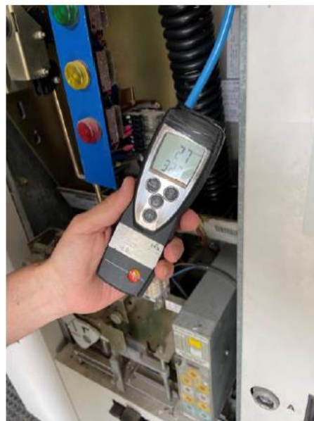
CELDA INTERRUPTOR AUTOMATICO
