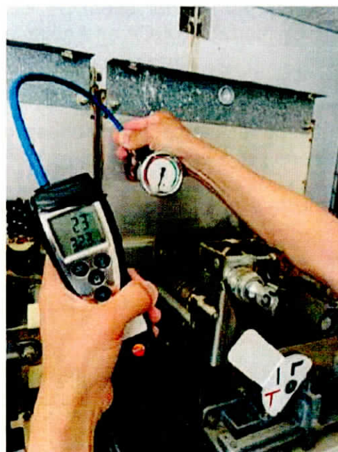
CELDA DE PROTECCION (TRAFO 2)
