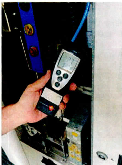
CELDA INTERRUPTOR AUTOMATICO
