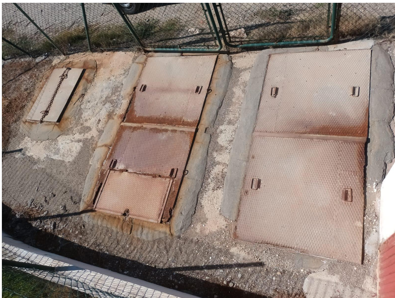
Estado tapas actuales EBAR Paraíso al Mar
