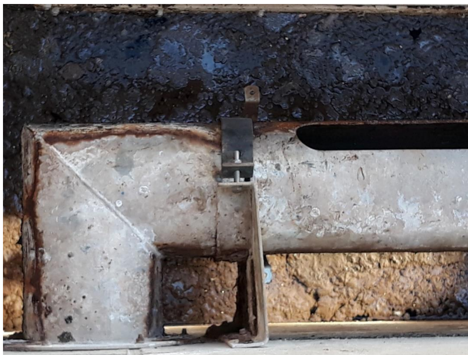
Acumulación de flotantes en el inicio del decantador secundario A por incapacidad de las bombas de flotantes de extraerlo
