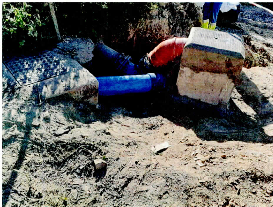
Conducción modificada para formar un cuello de cisne para asegurar el funcionamiento y medición de la conducción de salida siempre llena, así como arqueta acondicionada
