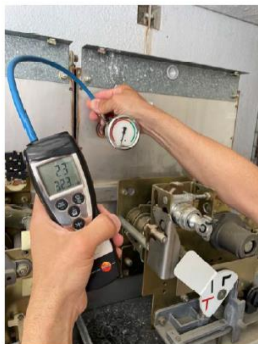
CELDA DE PROTECCION (TRAFO 2)
