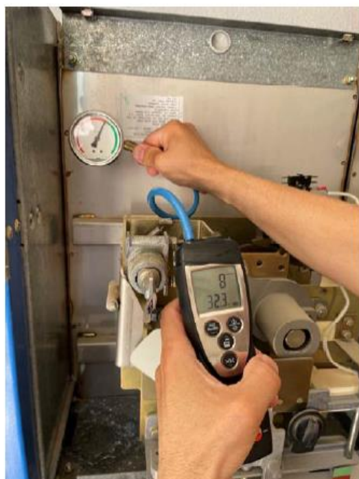
CELDA DE PROTECCION (TRAFO 1)
