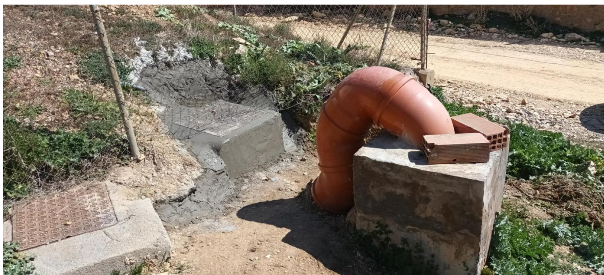
Conducción modificada para formar un cuello de cisne para asegurar el funcionamiento y medición de la conducción de salida siempre llena, así como arqueta acondicionada
