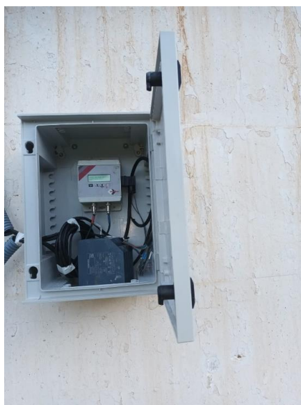
Display de monitorización de los datos enviados por las sondas, con transformador de voltaje requerido para su funcionamiento, instalado en lateral de decantador
