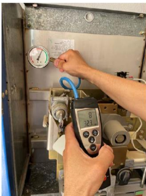
CELDA DE PROTECCION (TRAFO 1)
