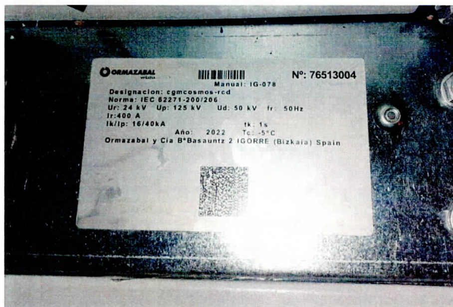
Placas de características de las cabinas instaladas
