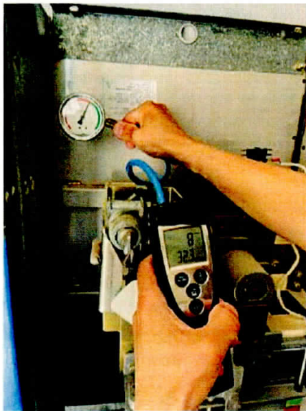
CELDA DE PROTECCION (TRAFO 1)
