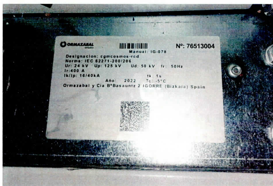
Placas de características de las cabinas instaladas
