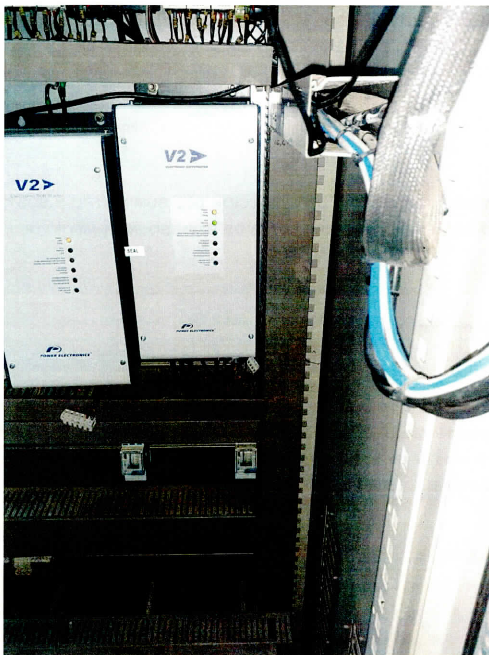
Fotografía de arrancador instalado y en funcionamiento, junto al de la bomba A que ya se sustituyó anteriormente
