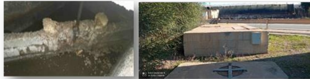
Arqueta de llegada y rebosadero
