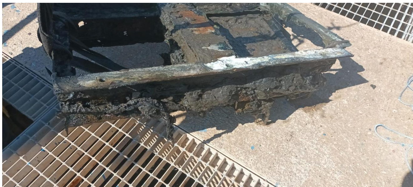
Fotografía del lateral de la compuerta descompuesto
