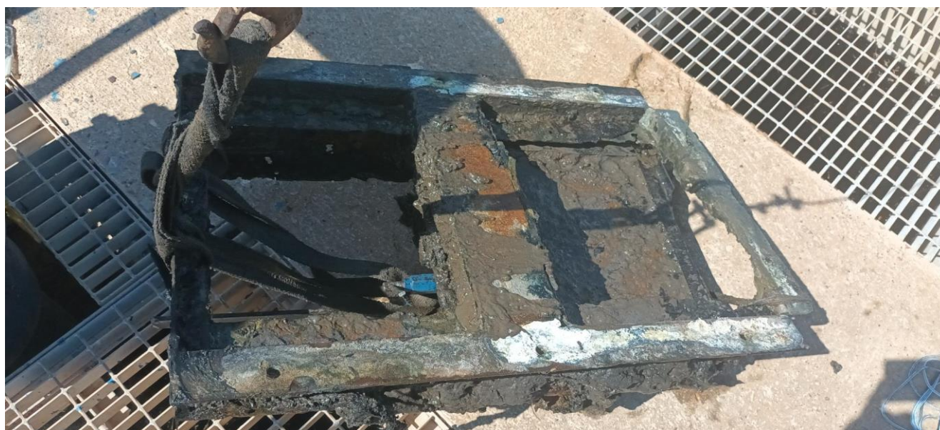
Compuerta deteriorada después de más de 20 años en servicio
