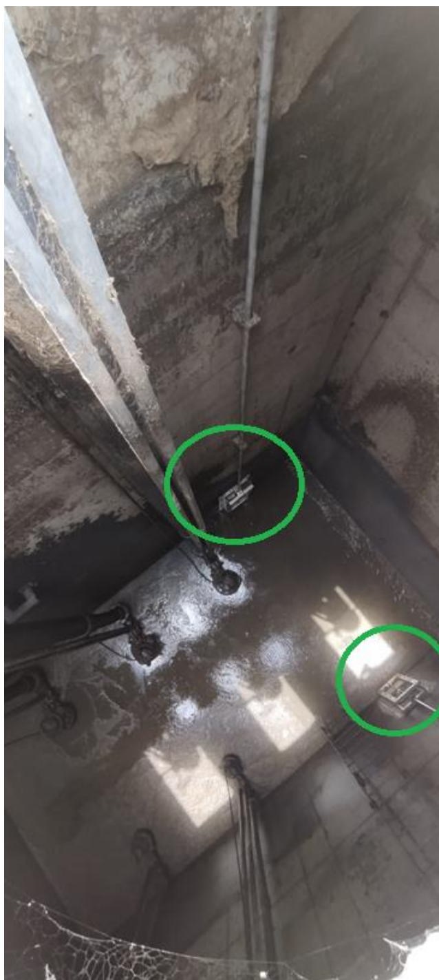
Vista de ambas compuertas de recirculación instaladas desde la arqueta de recirculación
