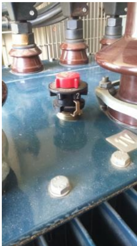
REGULACIÓN DEL TRANSFORMADOR 1
