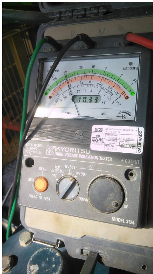
MEDIDA RESISTENCIA AIS. ENTRE ALTA Y BAJATENSIÓN
