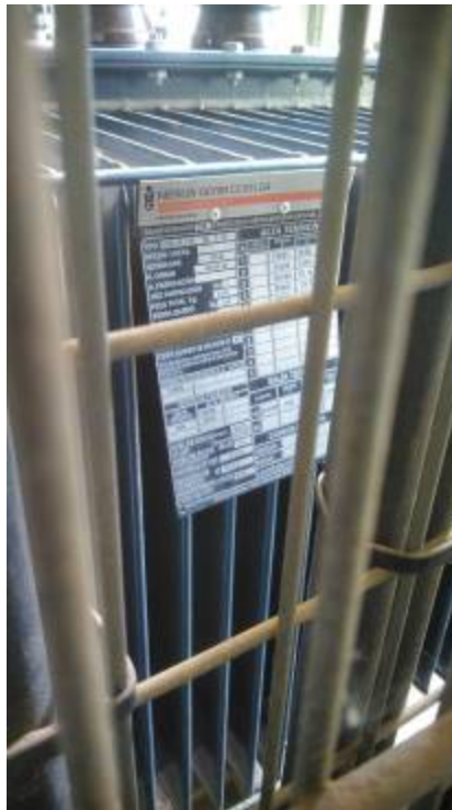
PLACA DE CARACTERÍSTICAS DEL TRANSFORMADOR 1
