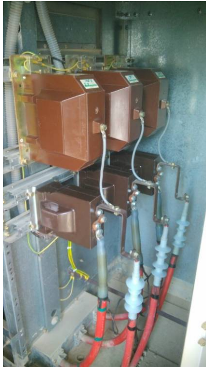
CELDA DE MEDIDA (INTERIOR)
