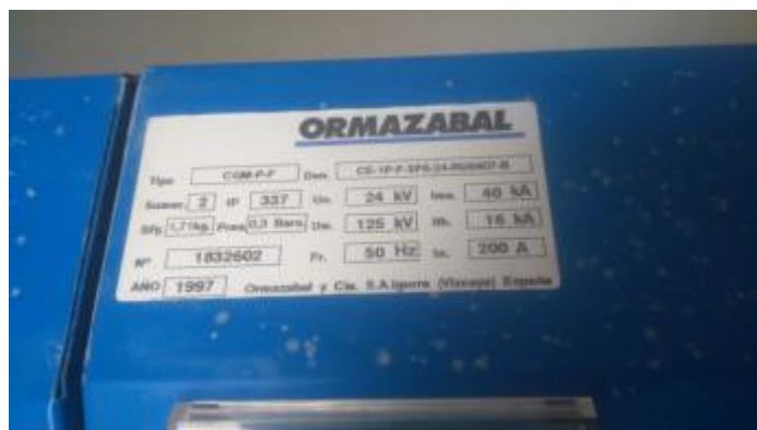
CELDA DE PROTECCIÓN 1
