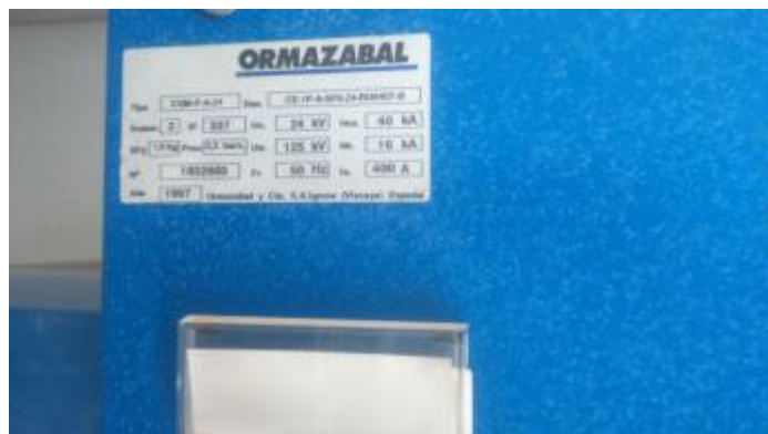
CELDA DE PROTECCIÓN GENERAL
