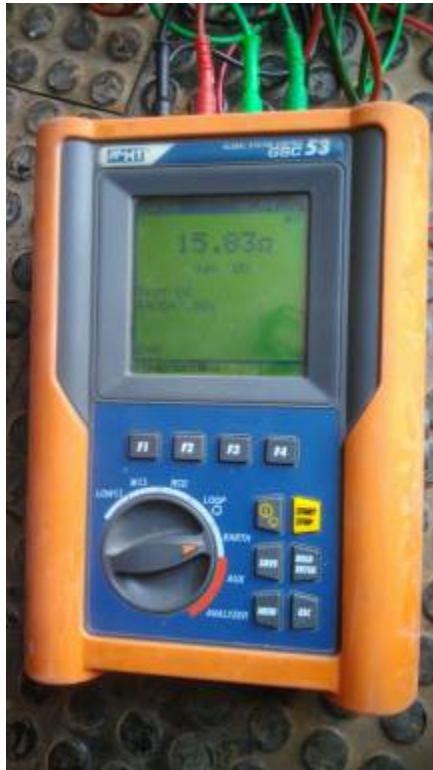
TOMA DE TIERRA NEUTRO TRANSFORMADOR 2
