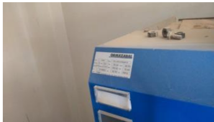
CELDA DE LÍNEA
