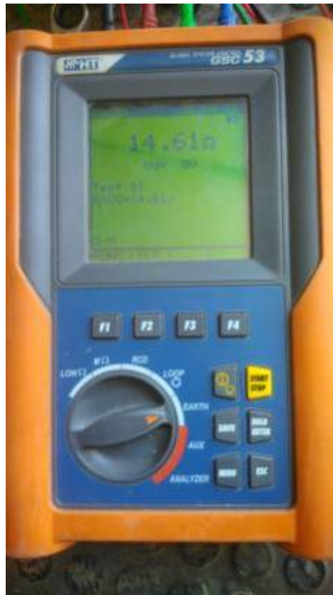
PUESTA A TIERRA DE HERRAJES TRANSFORMADORES
