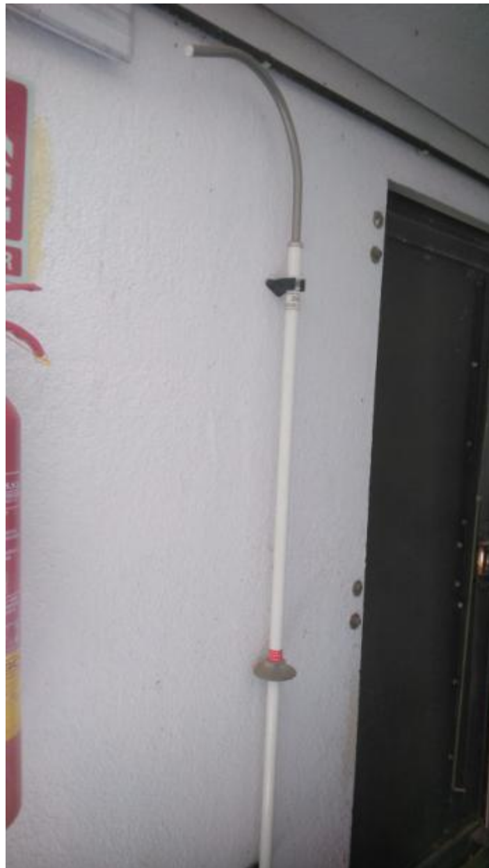
CENTRO DE TRANSFORMACIÓN (c.1)
