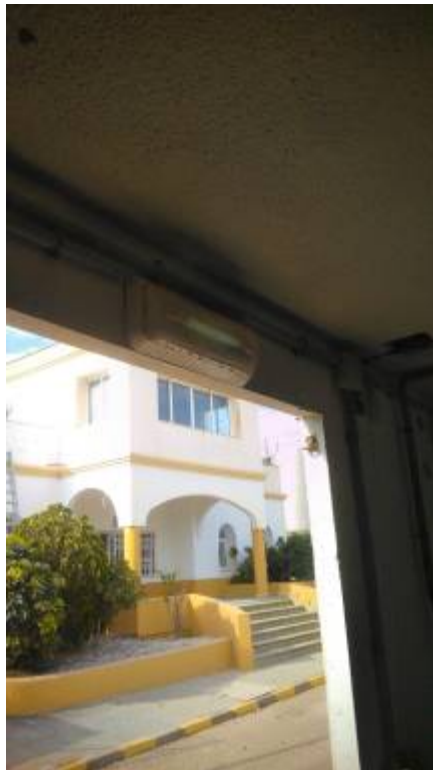
LUMINARIA DE EMERGENCIA(a)
