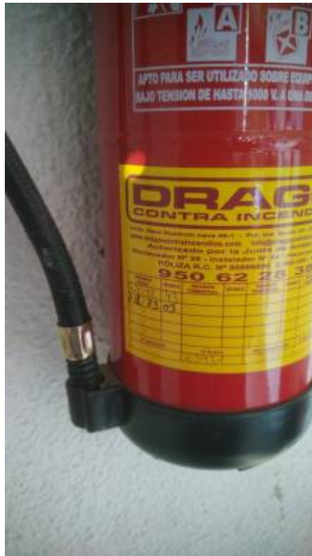
CENTRO DE TRANSFORMACIÓN (b)
