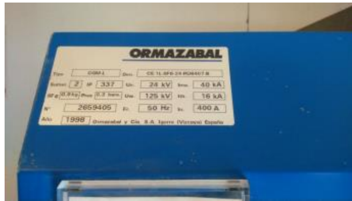
CELDA DE LÍNEA
