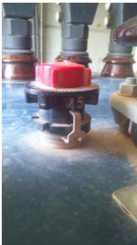
REGULACIÓN DEL TRANSFORMADOR 1
