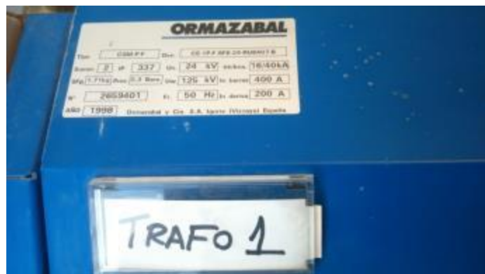
CELDA DE PROTECCIÓN 1
