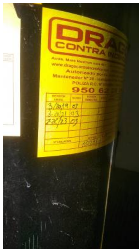
SISTEMA DE EXTINCIÓN AUTOMÁTICA
