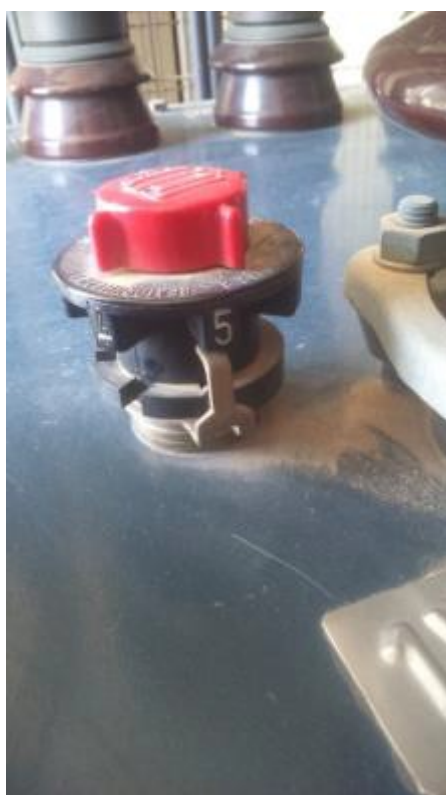
REGULACIÓN DEL TRANSFORMADOR 2
