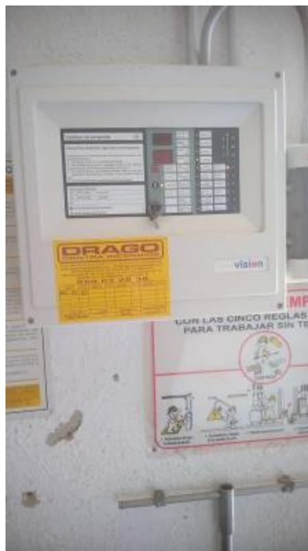
CENTRO DE TRANSFORMACIÓN (c)
