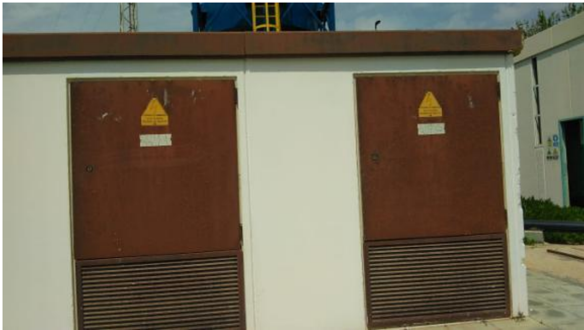
CASETA CENTROS DE TRANSFORMACIÓN
