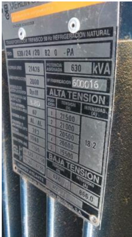
PLACA DE CARACTERÍSTICAS DEL TRANSFORMADOR 2
