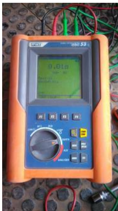
TOMA DE TIERRA NEUTRO TRANSFORMADOR 1
