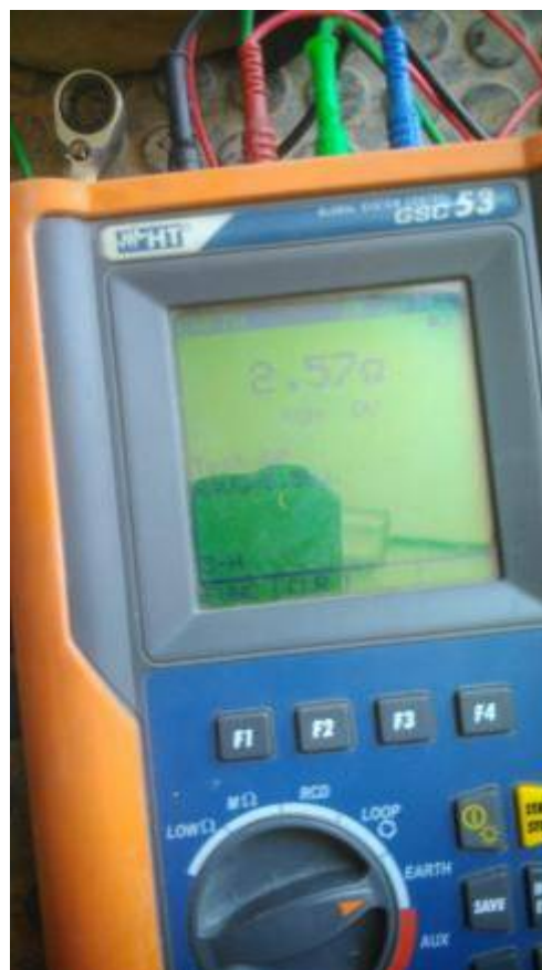
PUESTA A TIERRA NEUTRO TRANSFORMADOR 1
