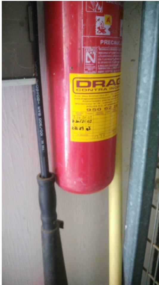
CENTRO DE TRANSFORMACIÓN (c)
