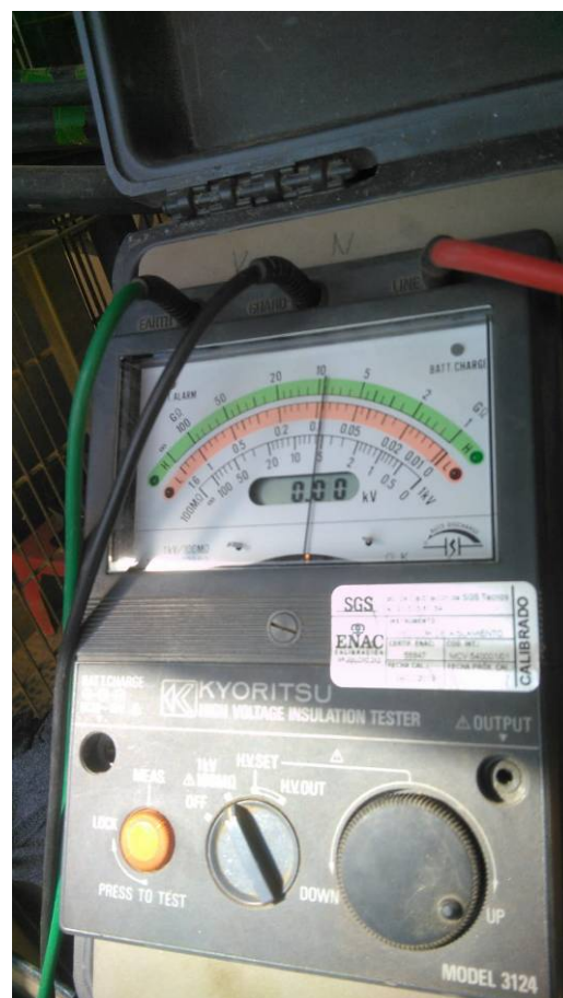
MEDIDA RESISTENCIA AIS. BAJA TENSIÓN
