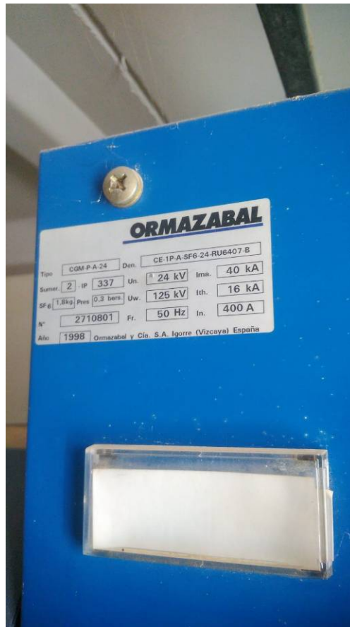
CELDA DE PROTECCIÓN
