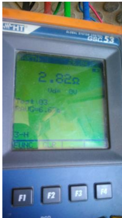
PUESTA A TIERRA NEUTRO TRANSFORMADOR 2
