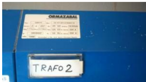
CELDA DE PROTECCIÓN 2
