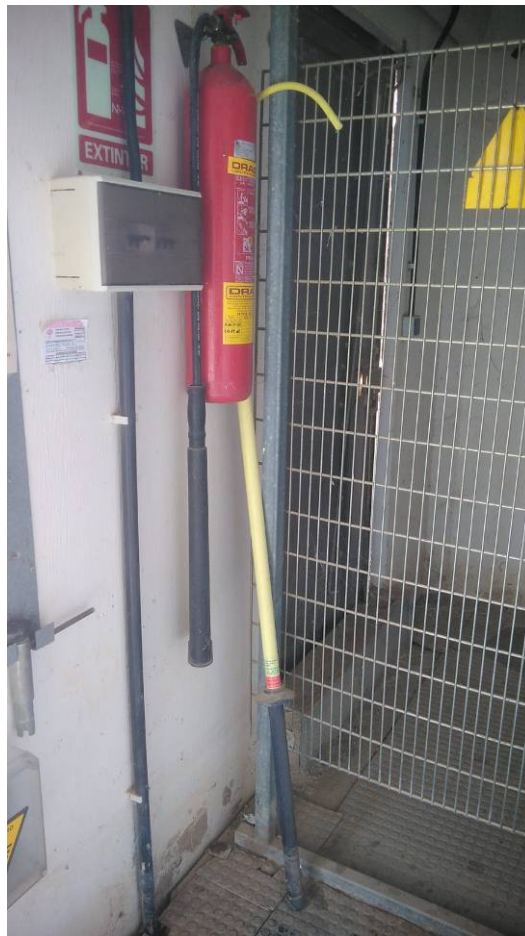
CENTRO DE TRANSFORMACIÓN (b)
