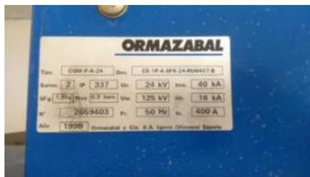
CELDA DE PROTECCIÓN GENERAL
