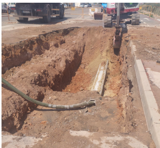
Imagen 3. Succión de colector mediante camión CIS.
