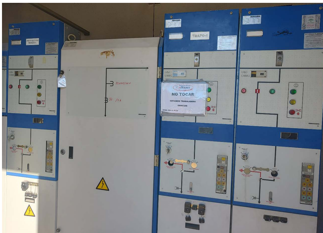
Fotografía de las cabinas de protección y medida del centro de transformación
