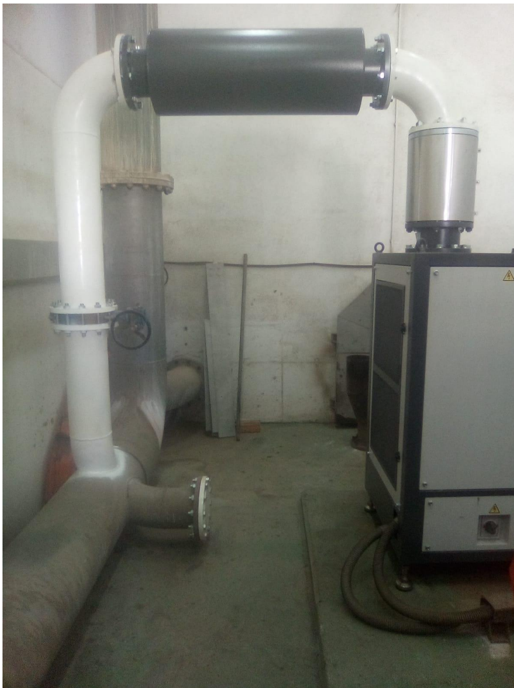
Soplante instalada y adaptación de conexión realizada para puesta en funcionamiento, junto con silenciador, carrete de adaptación y conducciones con válvula de corte
