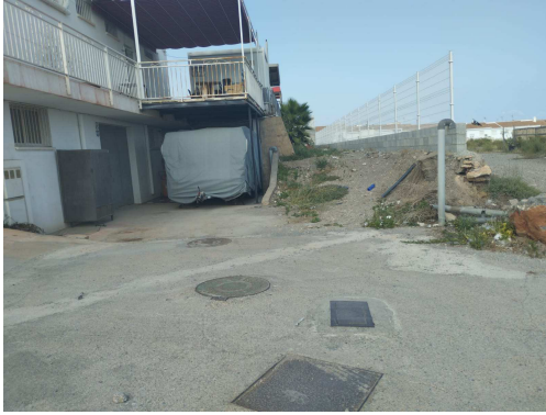
Foto3: Arquieta de toma de muestras
