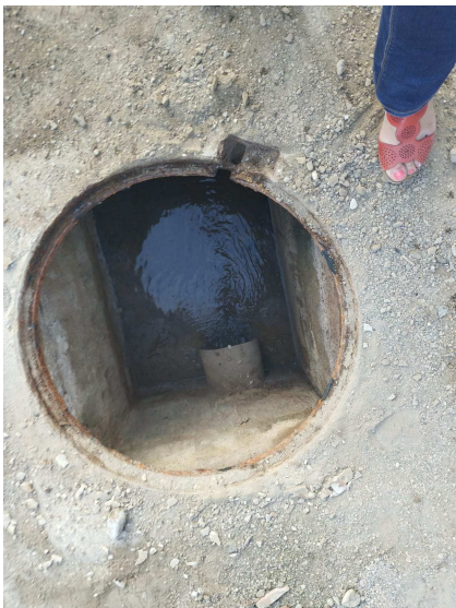
Foto1: Arqueta de conexión hacia la red municipal
