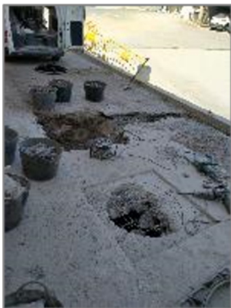
POZO BOMBEO DE RED INTERNA
