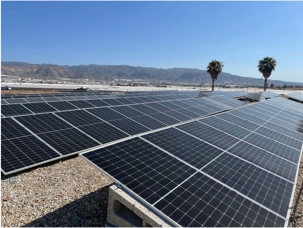
Paneles fotovoltaicos instalados.
