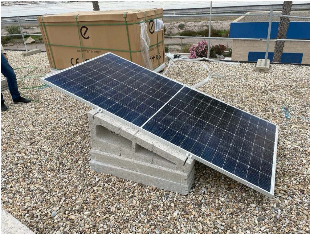
Panel fotovoltaico sobre soporte y lastres.
