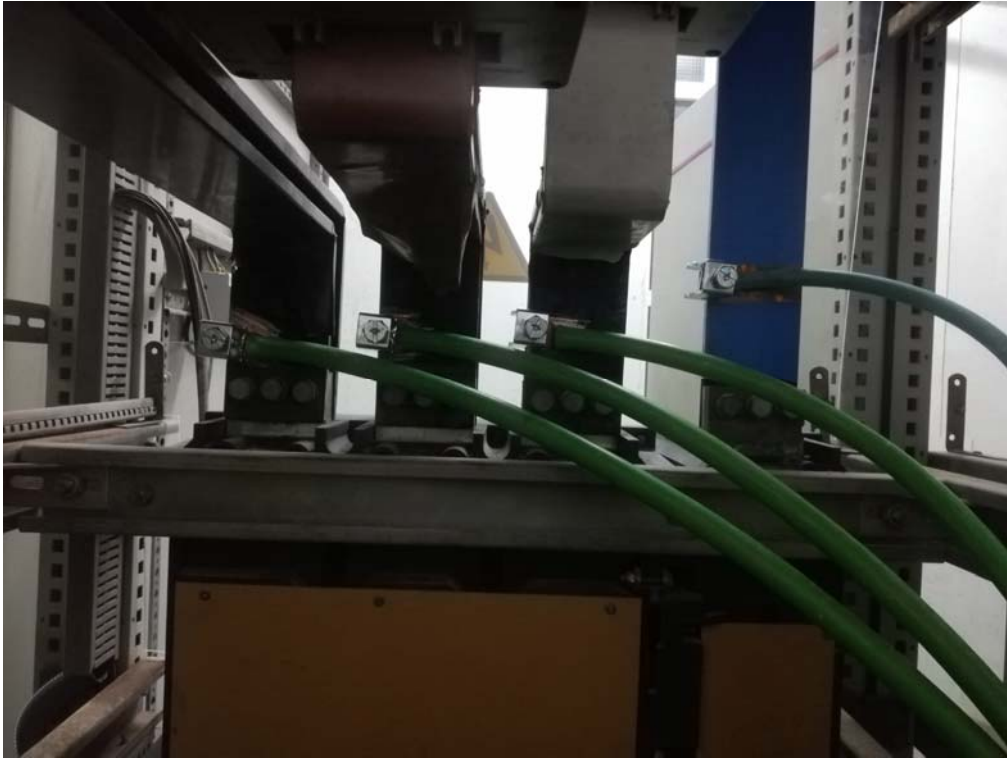
Conexionado de Cuadro General.
