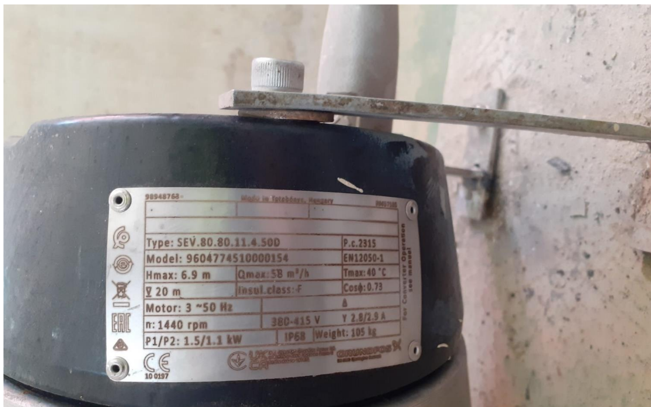
Placa de bomba instalada B
