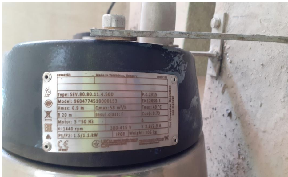
Placa de bomba instalada A
