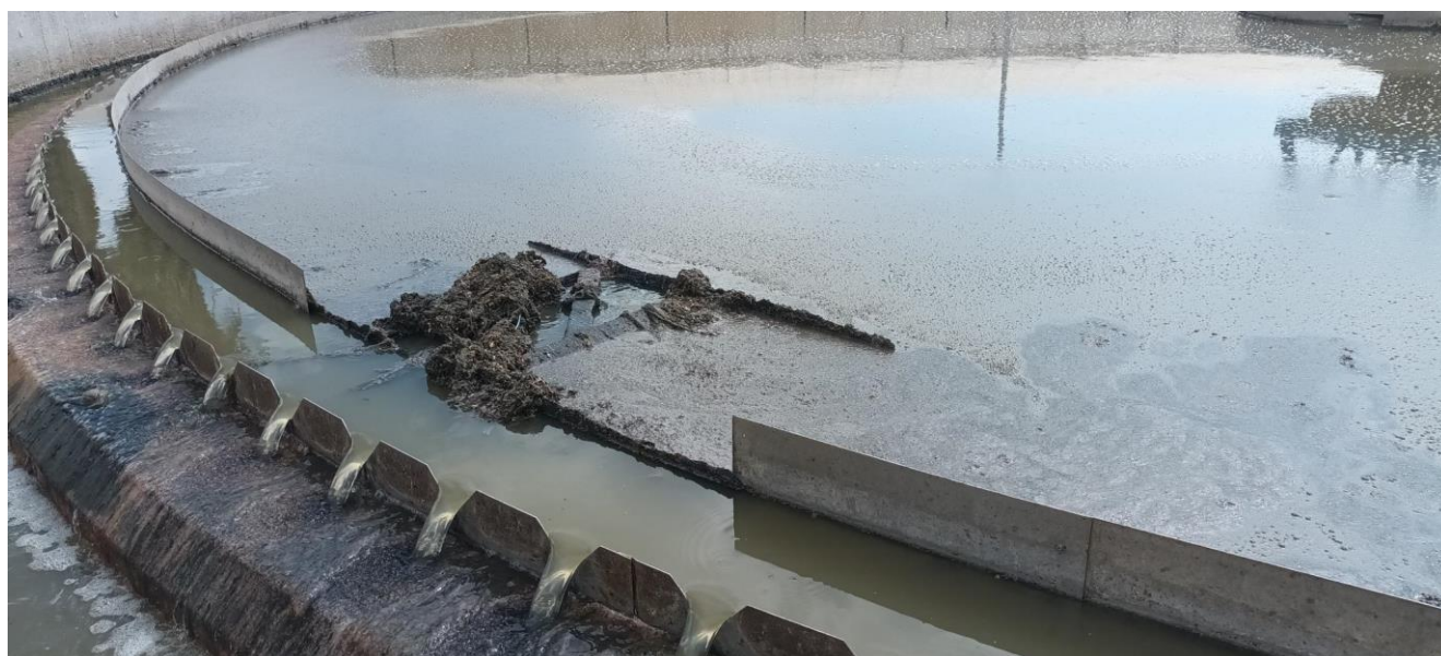
Decantadores primarios con buzón colmatado por agua y restos de flotantes
