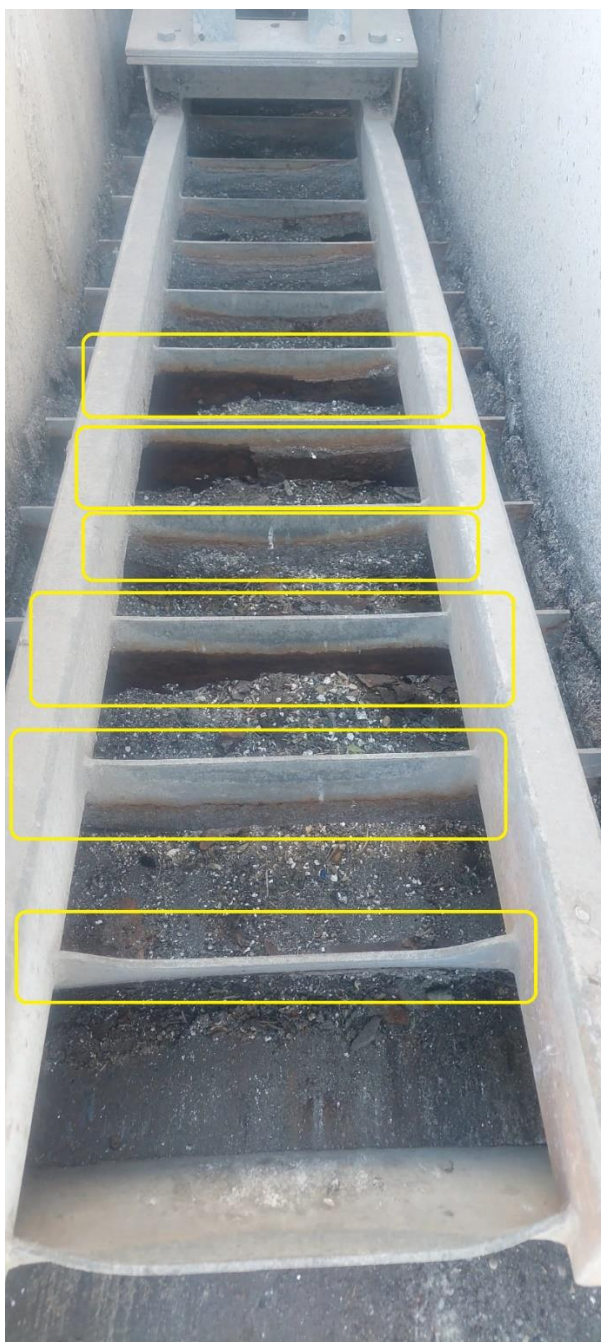
Detalle del desgaste de las paletas del módulo inferior del clasificador de arenas
