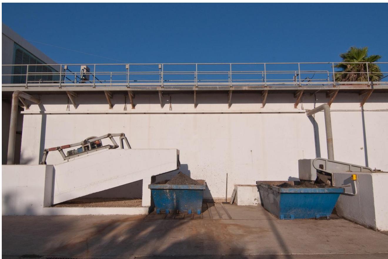
Fotografía de clasificador de arenas de la EDAR El Ejido a la izquierda
