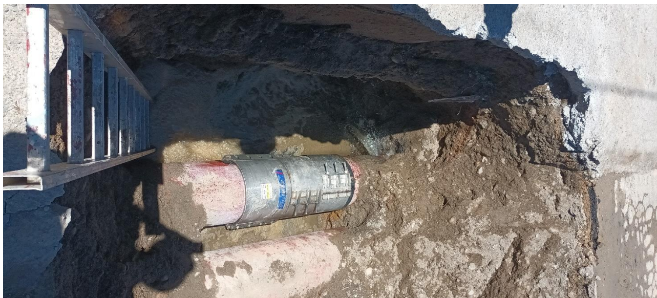
Conducción mencionada con nueva fuga detectada
