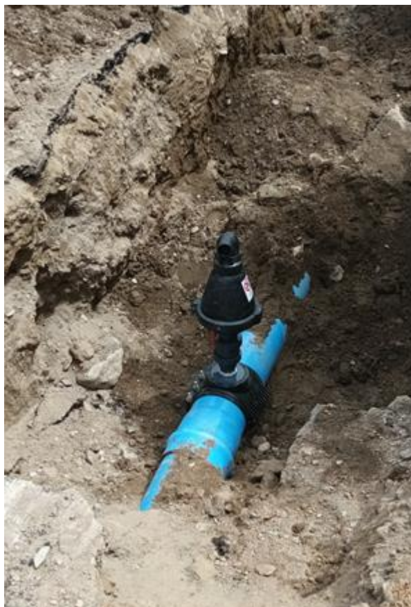
Ventosa instalada con válvula de corte para salida de aire de la conducción
