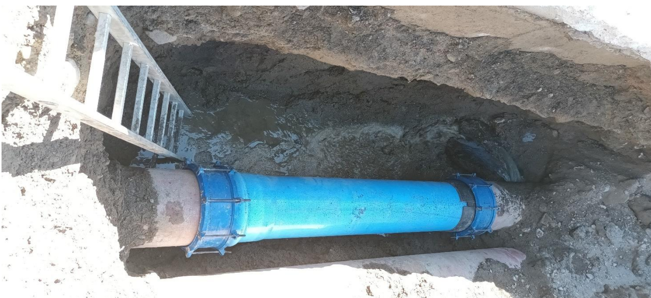
Tramo de conducción sustituida y nueva fuga detectada
