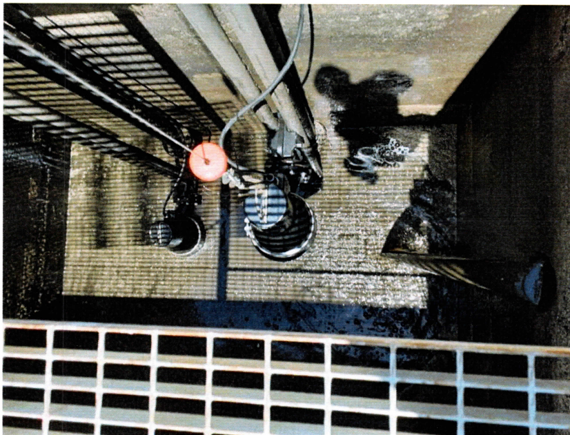
Bombas instaladas en el bombeo de vaciados de la EDAR Adra
