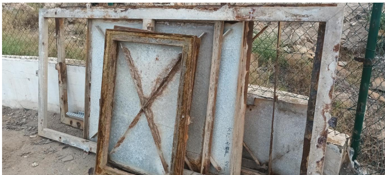
Arquetas con tapas en PRFV instaladas, así como las de metal desinstaladas ya corroídas en EBAR Paraíso al Mar
