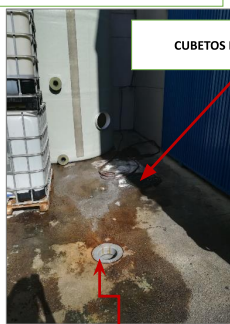
SUMIDERO PLUVIALES A RED MUNICIPAL
