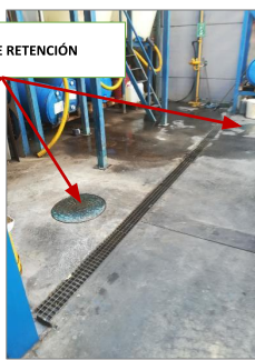
REJILLAS PARA RECOGIDA DE DERRAMES EN PATIO
