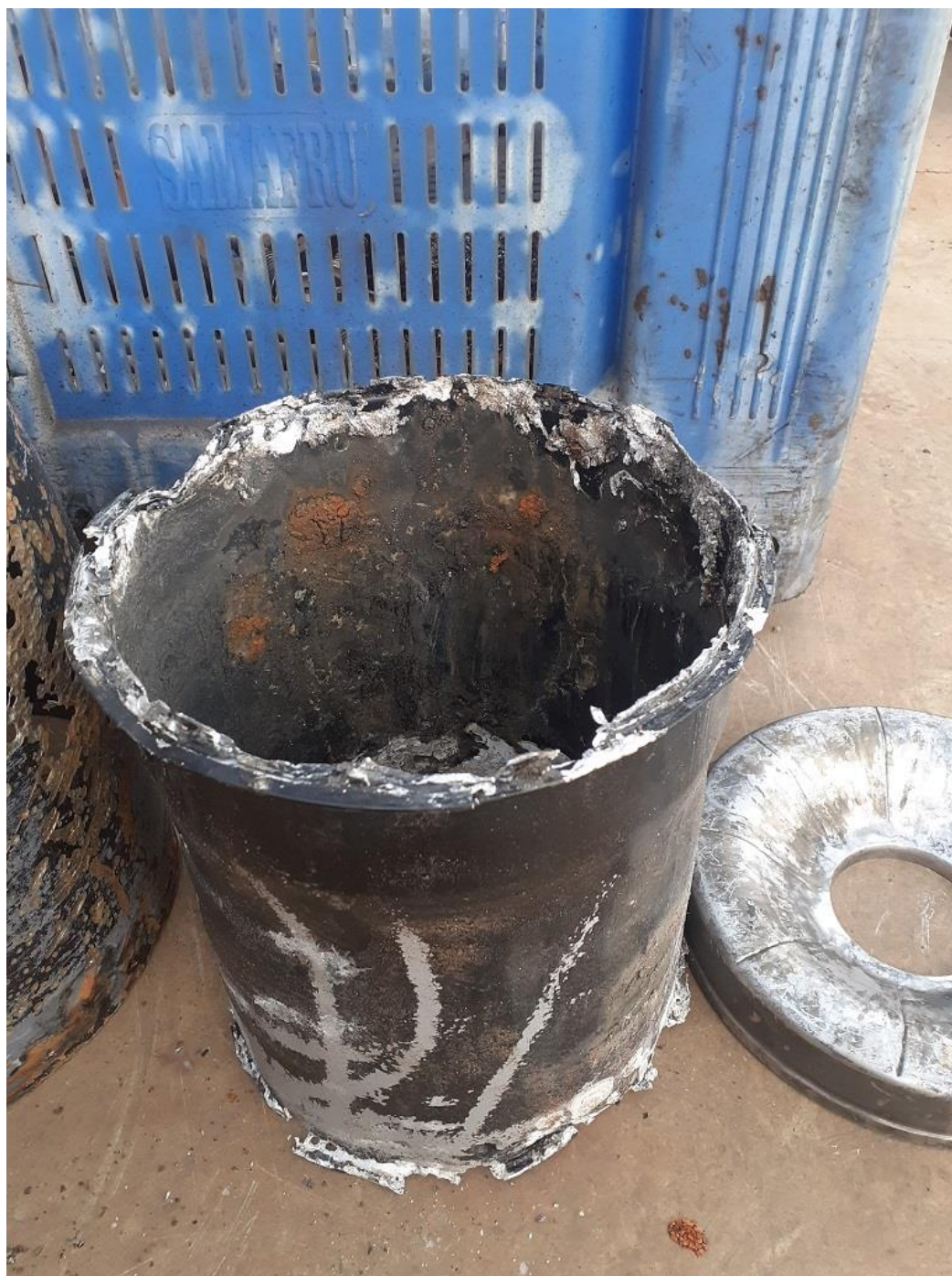
Cuerpo de la bomba, muy descompuesto
